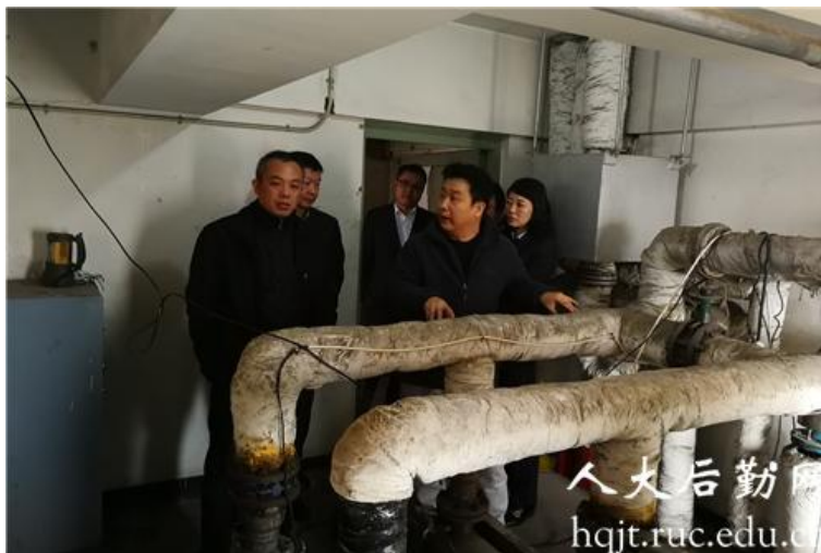
▲实地查看消防泵房
